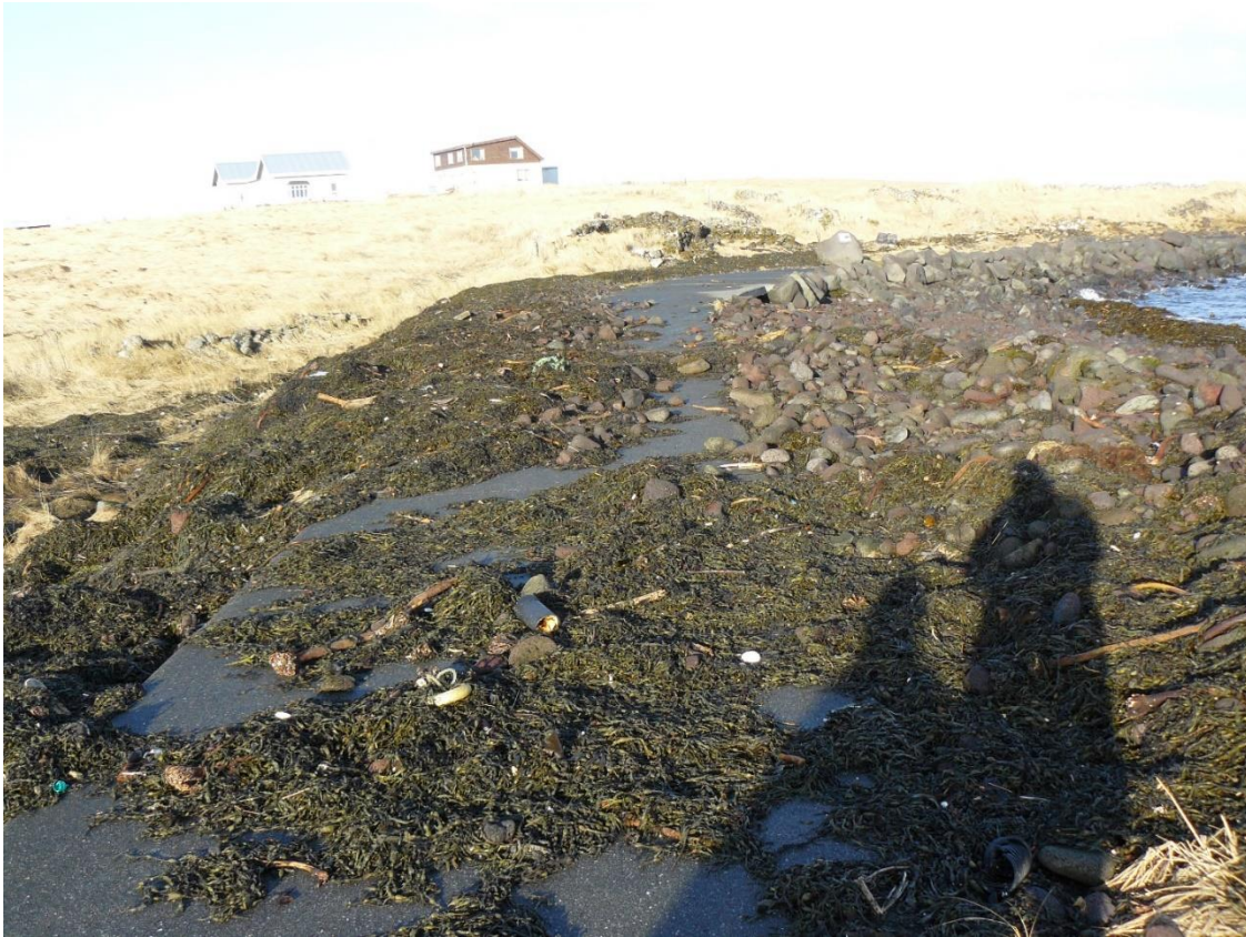
Mynd 3 Fyrir botni vogsins hafði nokkuð af grjóti og þara skolast á land. Grjótið var einungis sýnilegt þar sem garðurinn var ekki til staðar. Að baki varnargarðsins mátti víða sjá þara, sérstaklega handan stígsins. Mögulegt er að það hafi gefið yfir varnargarðinn og skolað þara á land, en engin ummerki voru um að aldan hafi losað grjót úr garðinum.
