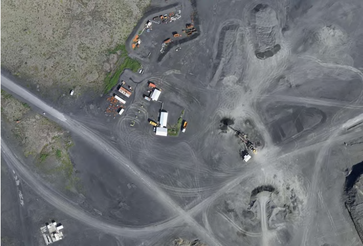
MYND 3.4 Loftmynd af aðstöðu starfsmanna og geymsluskúrum ÍAV í Stapafelli. Aðstaðan nýtist einnig starfseminni í Rauðamel. Loftmynd tekin af EFLU verkfræðistofu í júlí 2018.
